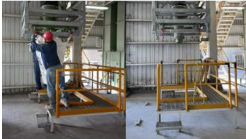
Antes (izquierda) y después (derecha) de modificación en plataforma y colocación de topes para montacargas.
