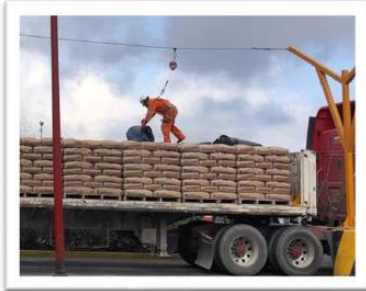
Trabajo en altura
