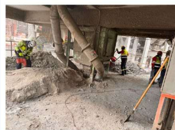
4.1 Antes: Fugas, derrames, falta limpieza
